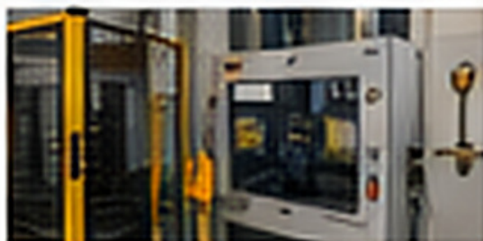
PORTAS COM INTERTRAVAMENTO
